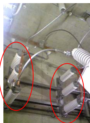
切離し断路器 (単巻変圧器用)
