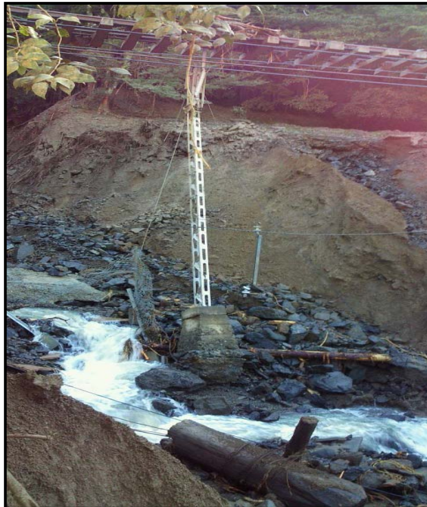
②内船駅～甲斐大島駅間 盛土崩壊
