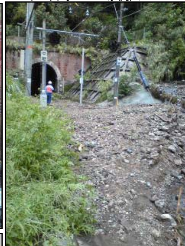
③芝川駅～稲子駅間 斜面崩壊による第二湯沢トンネル内等への土砂流入
