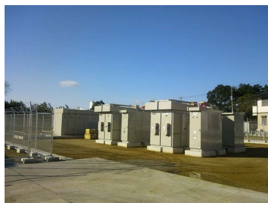
<武豊駅付近の変電所の状況（設置完了）>
