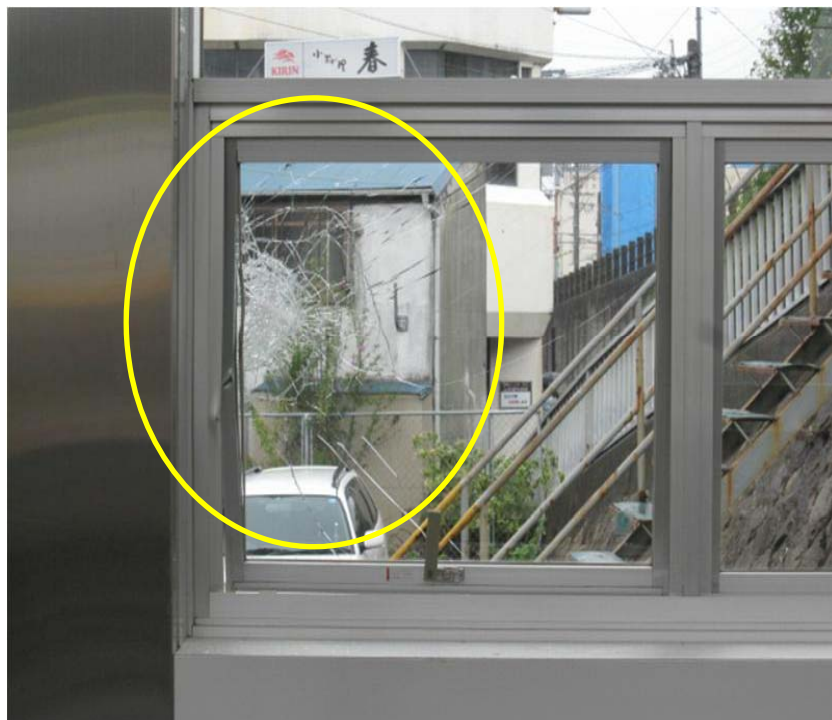
窓ガラス破損状況
