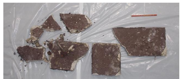
落下したボード
