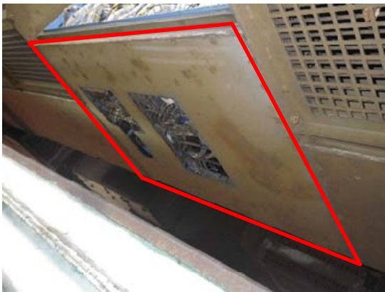
落失した状況
