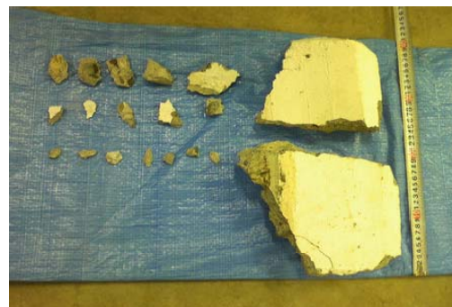
落下したコンクリート片
