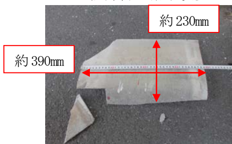
落下した屋根部材
