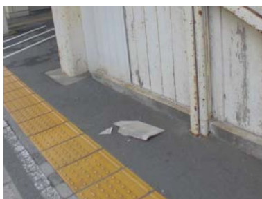
屋根部材の落下状況
