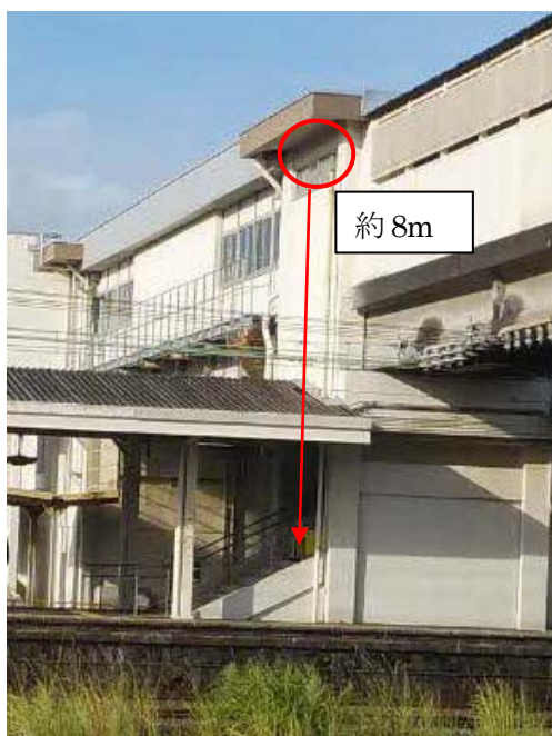
部材の落下状況
