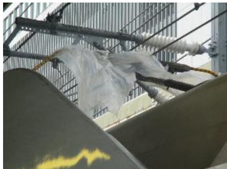
パンタグラフに付着した飛来物
