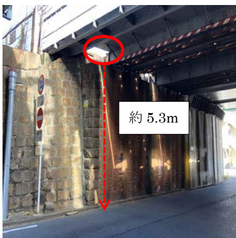
落下した箇所
