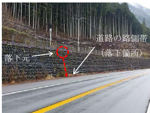
落下していた場所
