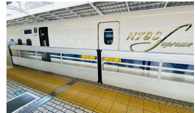
新大阪駅 大開口可動柵
