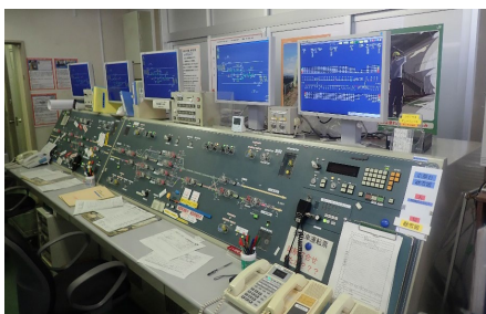
東海道新幹線 連動制御盤
