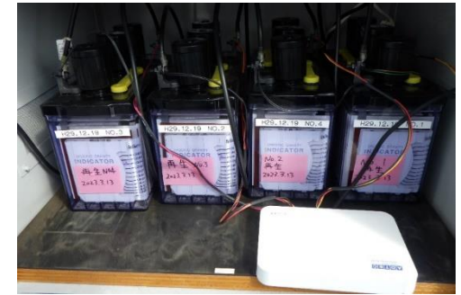
実地での検証の様子 (電圧値を常時監視)
