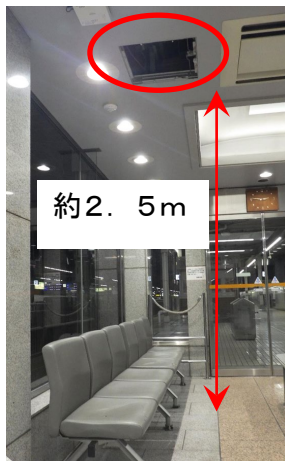
落下した箇所（ホーム待合室内）
