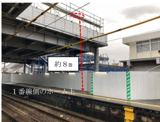
落下した箇所
