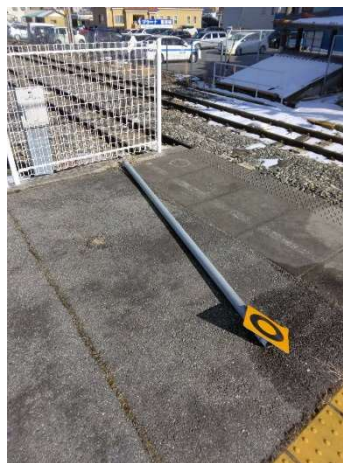
倒れていた箇所（下りホーム端）
